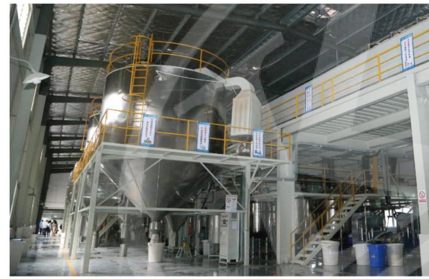
喷雾塔 Spray tower
